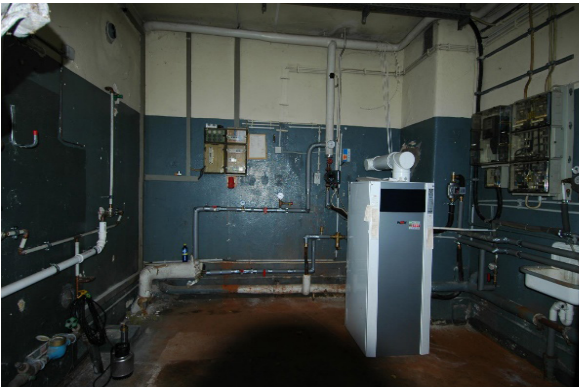
Abbildung 9: Gebäude B1, Schulungsgebäude, Heizungsraum
