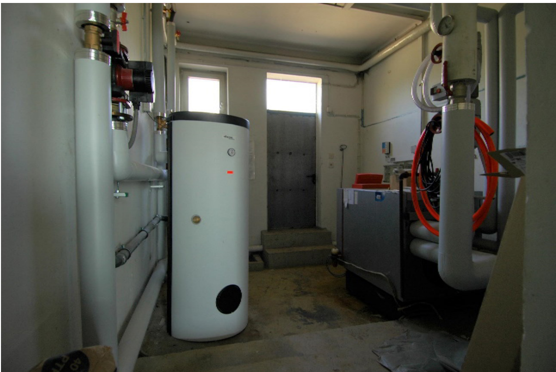
Abbildung 30: Gebäude 3, Bürogebäude, Heizungs- und Technikraum
