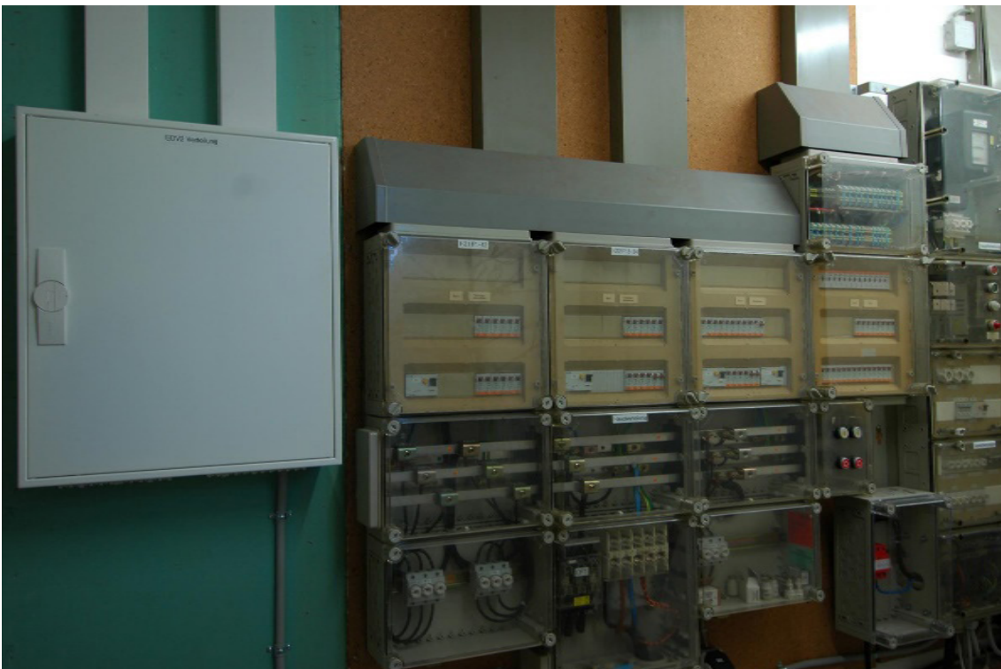
Abbildung 21: Gebäude B3a, Kantine, Erdgeschoss, Technikraum
